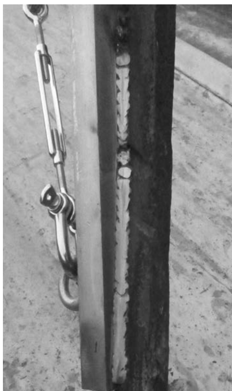
Dettaglio della saldatura dopo dei mesi
