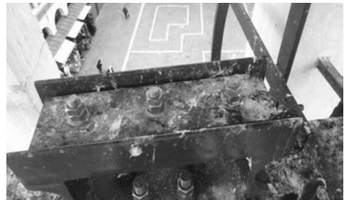
Elevata presenza di guano sopra al ceppo della campana maggiore
